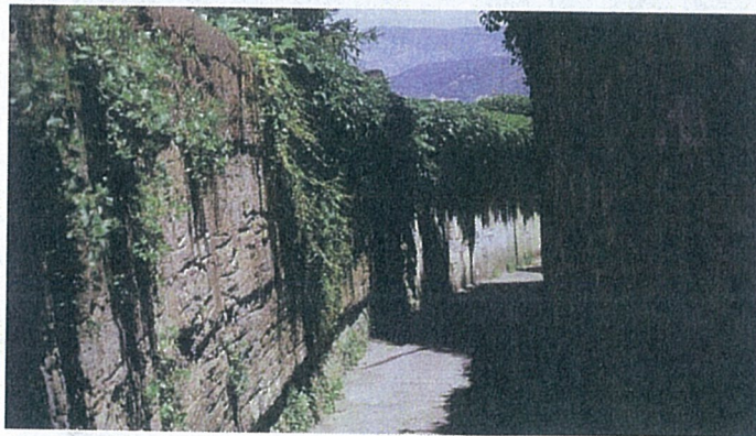
Sorrento, Vico terzo Rota: vecchia muratura in tufo con solchi di erosione, (da M. Guida, A. Vallario "Muri Sorrentini", 2003)
